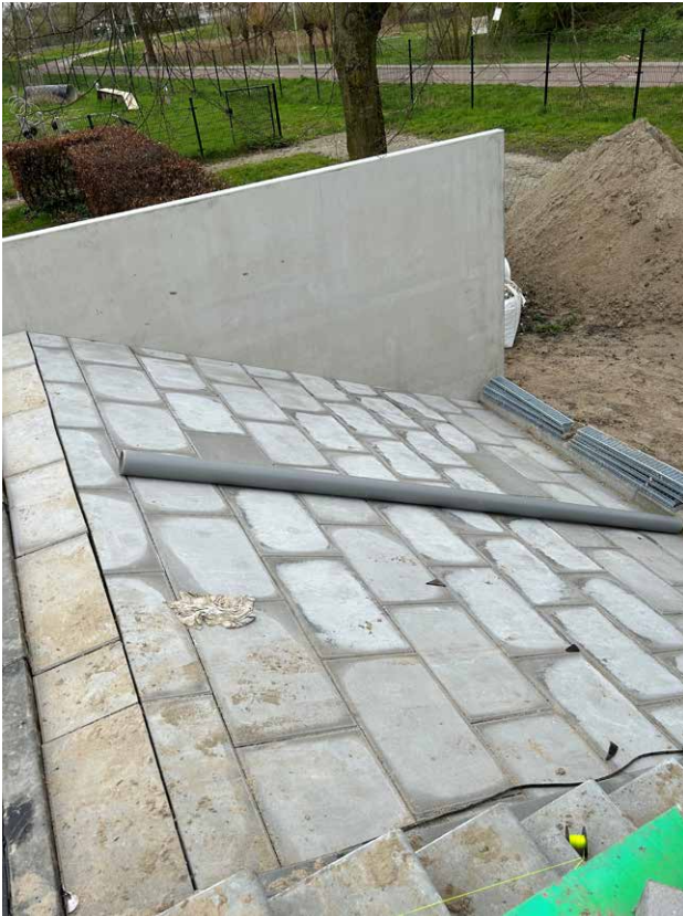
^ De dakvloer van het hellende dak bestaat uit tegels. (Foto: Koninklijke Ginkel Groep)
